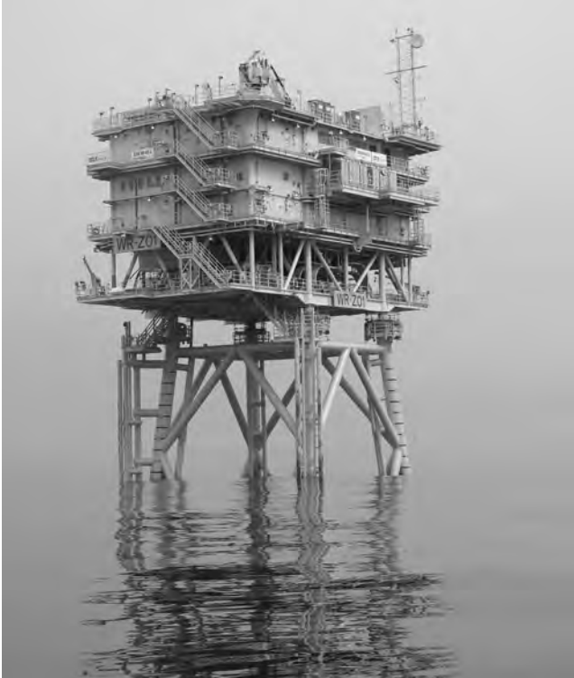
Figure 4 : Sous-station électrique sur sa jacket
