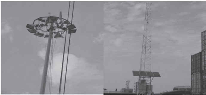
Figure 3 : À gauche, une photo d'un projecteur à quai équipé de caméras et une photo d'un équipement de transmission des informations alimenté par un panneau solaire sur le terminal de préparation des escales au poste 8. À droite, une photo d'équipement de transmission sur le terminal Coman au port de Cotonou
